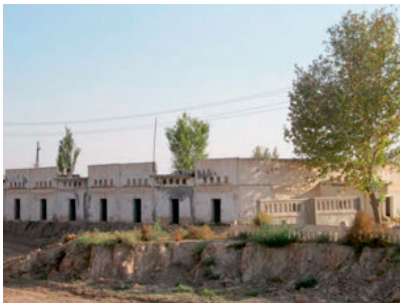
Фото 10.1: Ущерб, причиненный зданию туберкулезного отделения районной больницы в результате оползня
