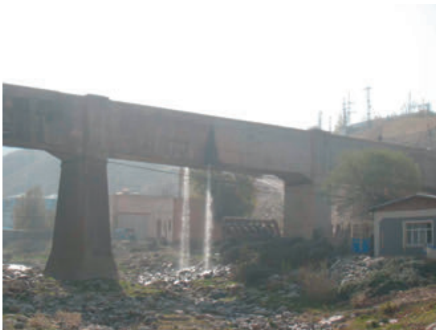
Фотография 7.1: Поврежденный акведук, Душанбе
