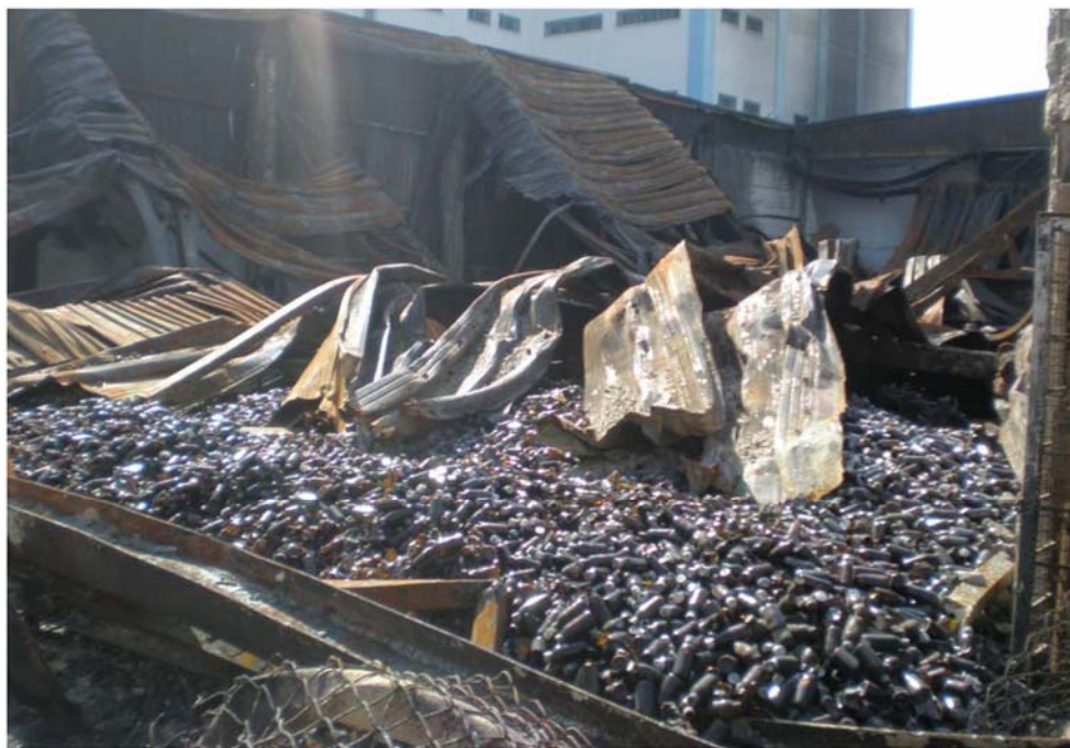
Foto 15: Almacén destruido del OOPS.
