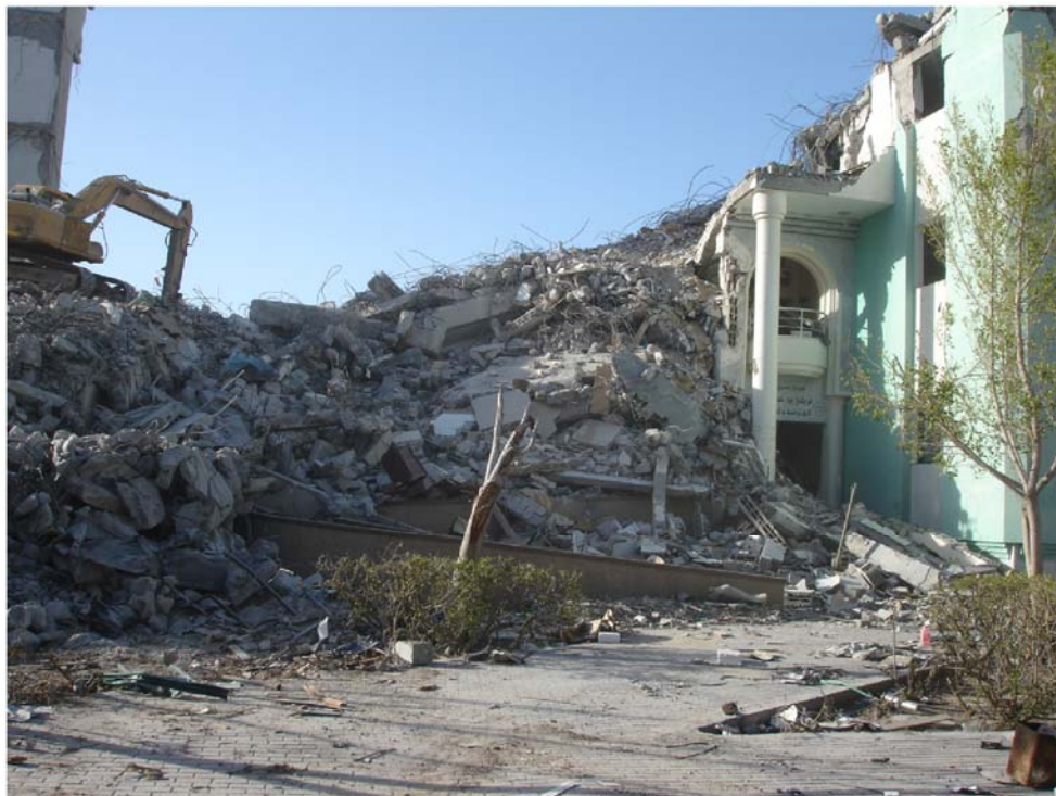
Foto 11: Vista del edificio de la Facultad de Ingeniería completamente destruido.
