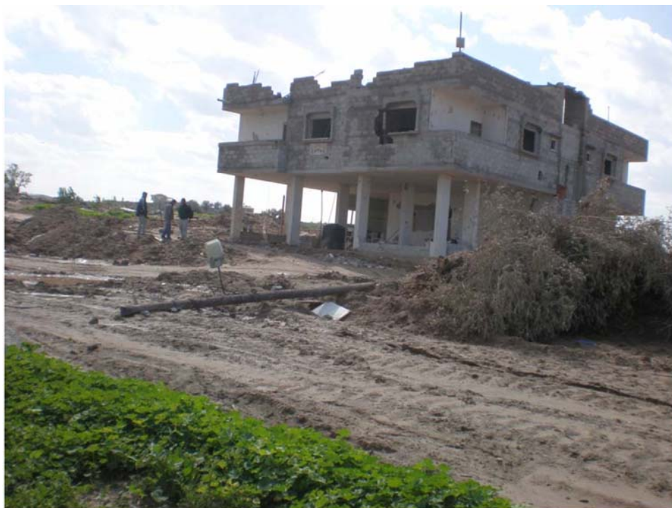
Foto 24: Daños en la vivienda de la familia Hajjaj y los terrenos colindantes.
