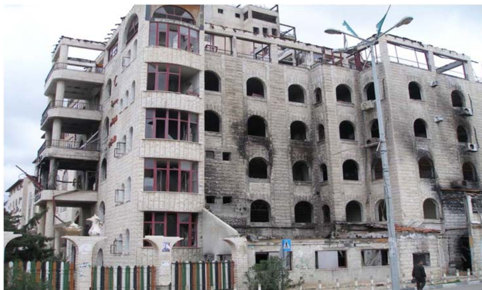
Foto 7: Daños en el hospital Al-Quds.
