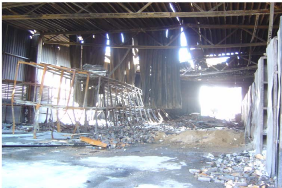
Foto 14: Almacén destruido del OOPS.
