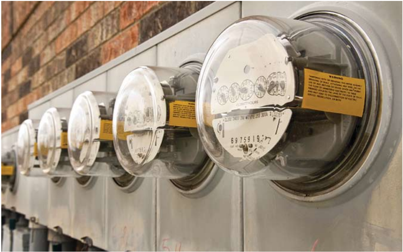
عدادات الكهرباء في إحدى المباني في المدينة
