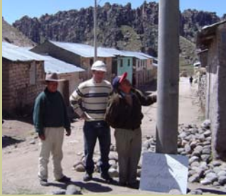
Electrificación Distrito de Sukuytambo Y Comunidad Huisa Collana
