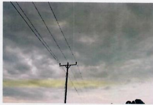
Domage sur la ligne électrique
