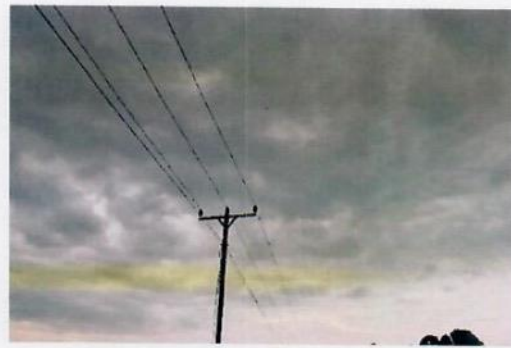
Domage sur la ligne électrique
