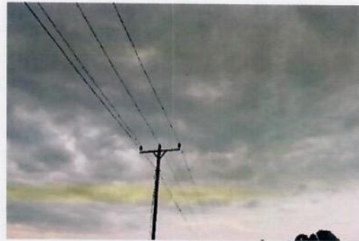
Domage sur la ligne électrique
