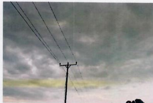
Domage sur la ligne électrique
