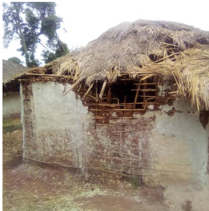
Dommages causés aux habitations du village de Ndr'li par le bombardement
