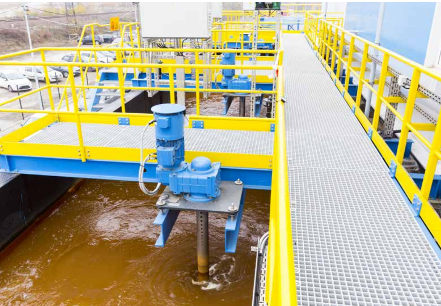
Station de traitement de l'eau de pluie Photo : © Cylonphoto/Shutterstock.com
