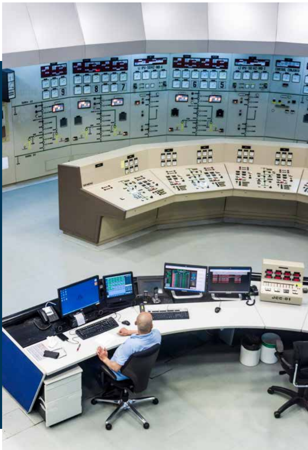
Salle de commande du barrage d'Itaipu sur la rivière Paraná, à la frontière du Brésil et du Paraguay Photo : © Matyas Rehak/Shutterstock.com
