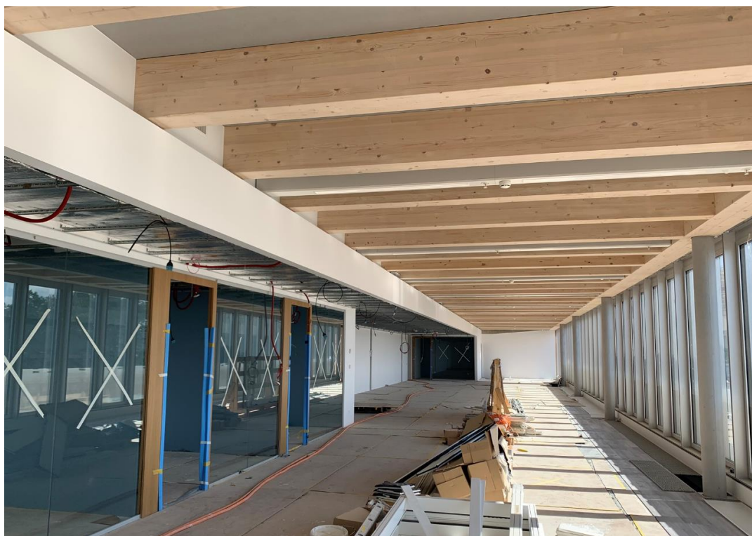
Figure III État du chantier de construction du bâtiment H (intérieur du niveau 1) au 31 août 2020
