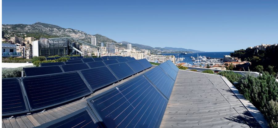
Panneaux solaires sur un immeuble domanial HQE
