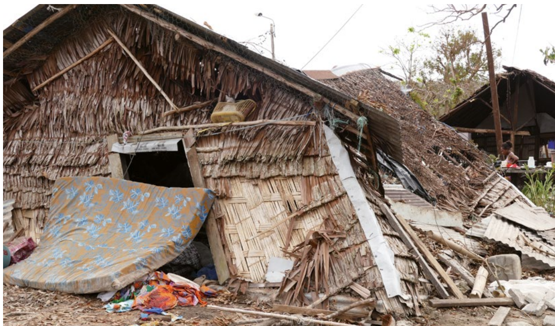
Обрушившийся на Вануату циклон Пэм (2015) разрушил и повредил 15 000 домов (Источник: Сильке фон Брокхаузен/ПРООН Вануату)
