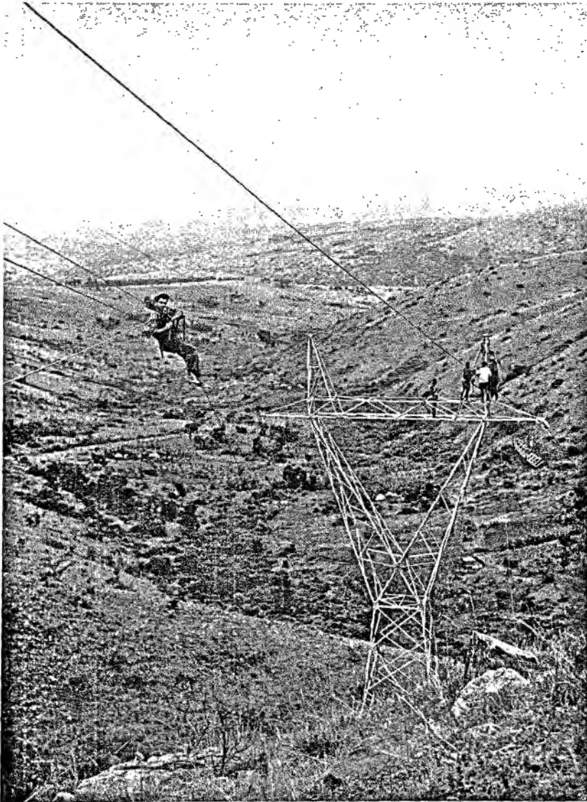
Montage de la ligne à haute tension (70.000 volts) destinée à amener l'énergie électrique qui sera fournie par la Centrale Hydro-électrique de la Ntaruka.
