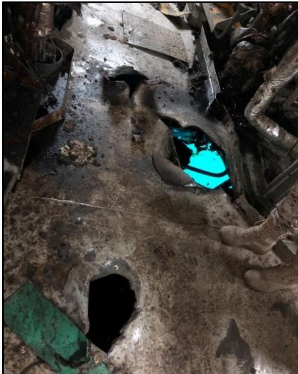
图 3 Amjad 号发动机舱净化器室的受损情况
