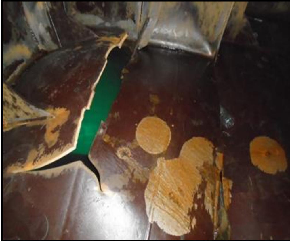
Imagen 12: Daños en el suelo de la sala de máquinas del Al-Marzoqah.
