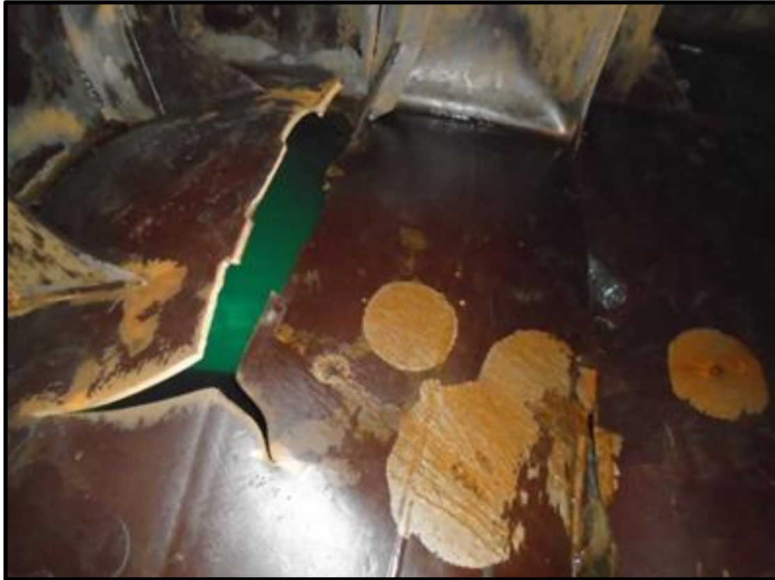
الشكل ١٢: صورة توضح الضرر الذي لحق بأرضية غرفة محركات الناقلة "المرزوقة"
