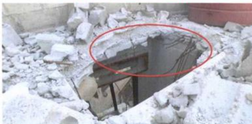
Пробоина в крыше имеет размеры 166 x 105 см Наличие внутри пробоины торчащей арматуры из мягкой невязанной проволоки свидетельствует о её умышленном механическом расширении
