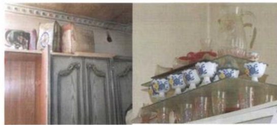
Проникание баллона в помещение под крышей не допускает его перемещение в сторону от траектории проникания без причинения сопутствующих повреждений мебели, пола, стен и остекления окон
