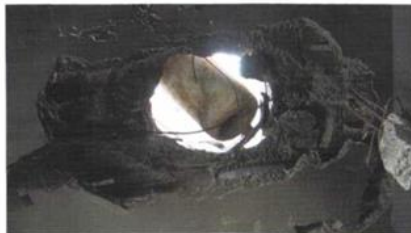
Следы копоти и разрушение арматуры преграды в пробоине
