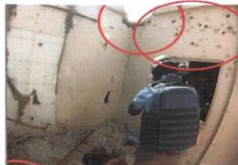
Следы осколков на стенах балкона
